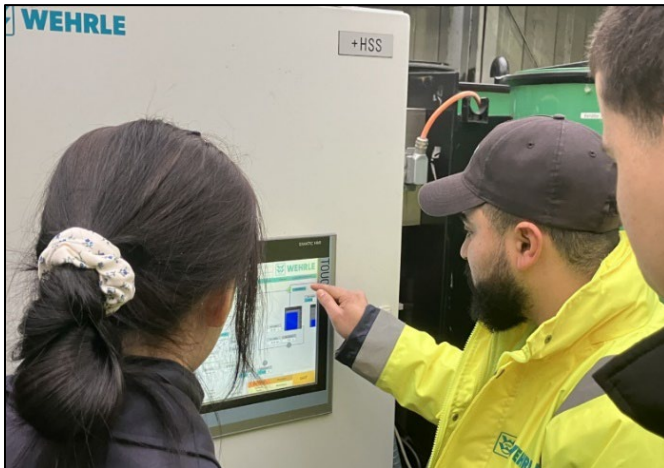
Inbetriebnahme Ultrafiltration in Bochum – Foto: SMS
