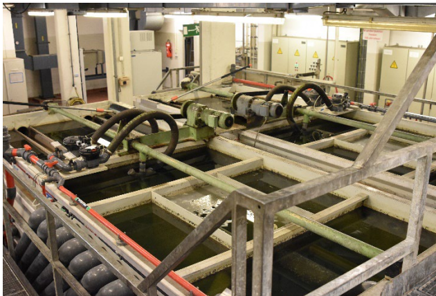
Anlage VW: Aktuelle Abwasserreinigungsanlage im VW-Werk in Braunschweig (Quelle: VW-Werk Braunschweig)
