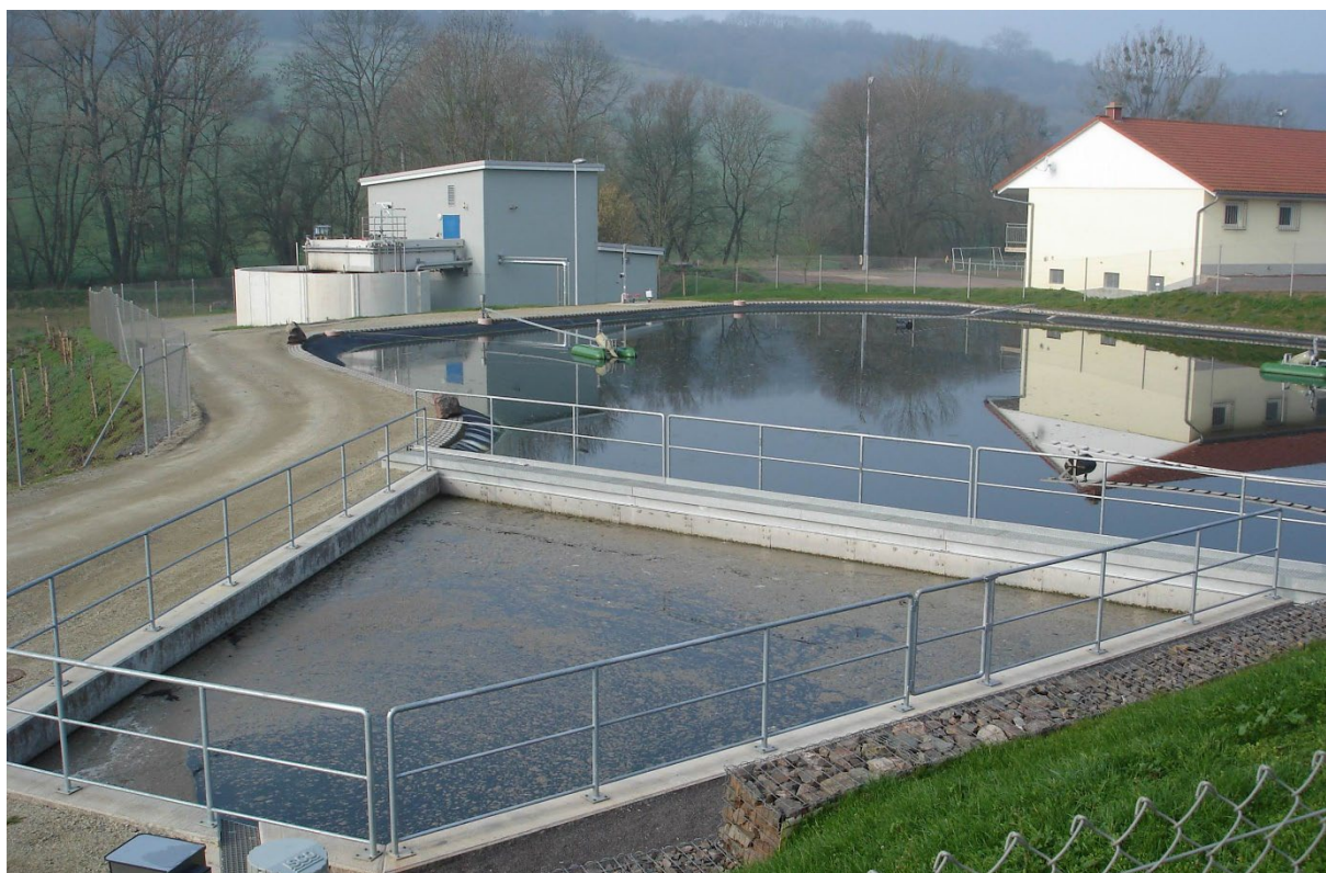
Abb. 7: Gesamtansicht der LAGOON-MEMB Demonstrationsanlage – im Vordergrund die Anlagenstufe 1 (belüfteter Vorteich), im Hintergrund die Anlagenstufe 2 (Membranbelebungsstufe) mit dem zugehörigen Betriebsgebäude. Quelle: A. Ante.
