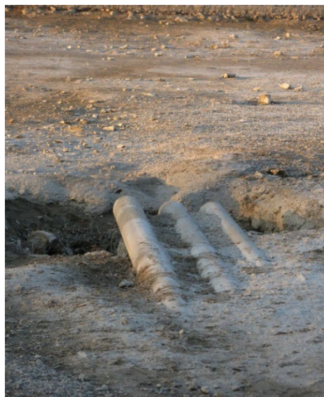
Abb. 8: Flusswasserentnahmeverrichtung für das Frischwasser des Kraftwerkes in Esfahan. Quelle: A. Ante.
