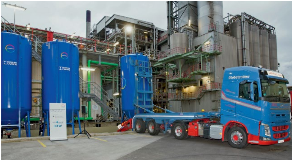
Recycling-Anlage am Standort Krefeld-Uerdingen von Covestro (Quelle: Covestro)
