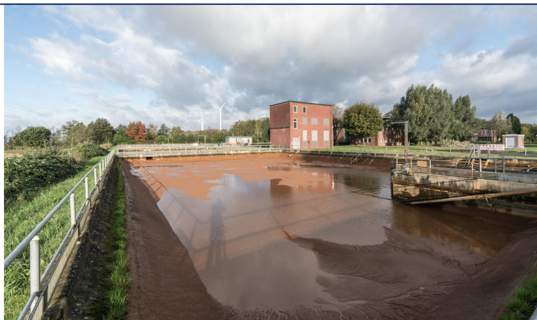
Filterspülwasser-Becken (Quelle: Hamburg Wasser)
