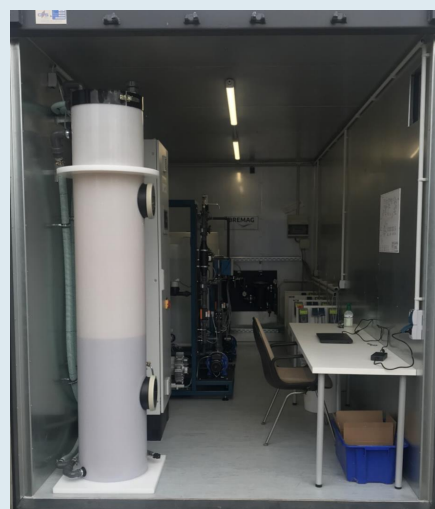
Blick in Versuchscontainer (Quelle: HAMBURG WASSER)
