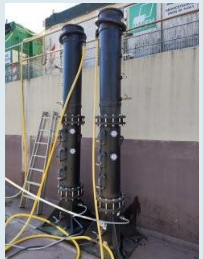
Sandfiltersäulen (Quelle: HAMBURG WASSER)
