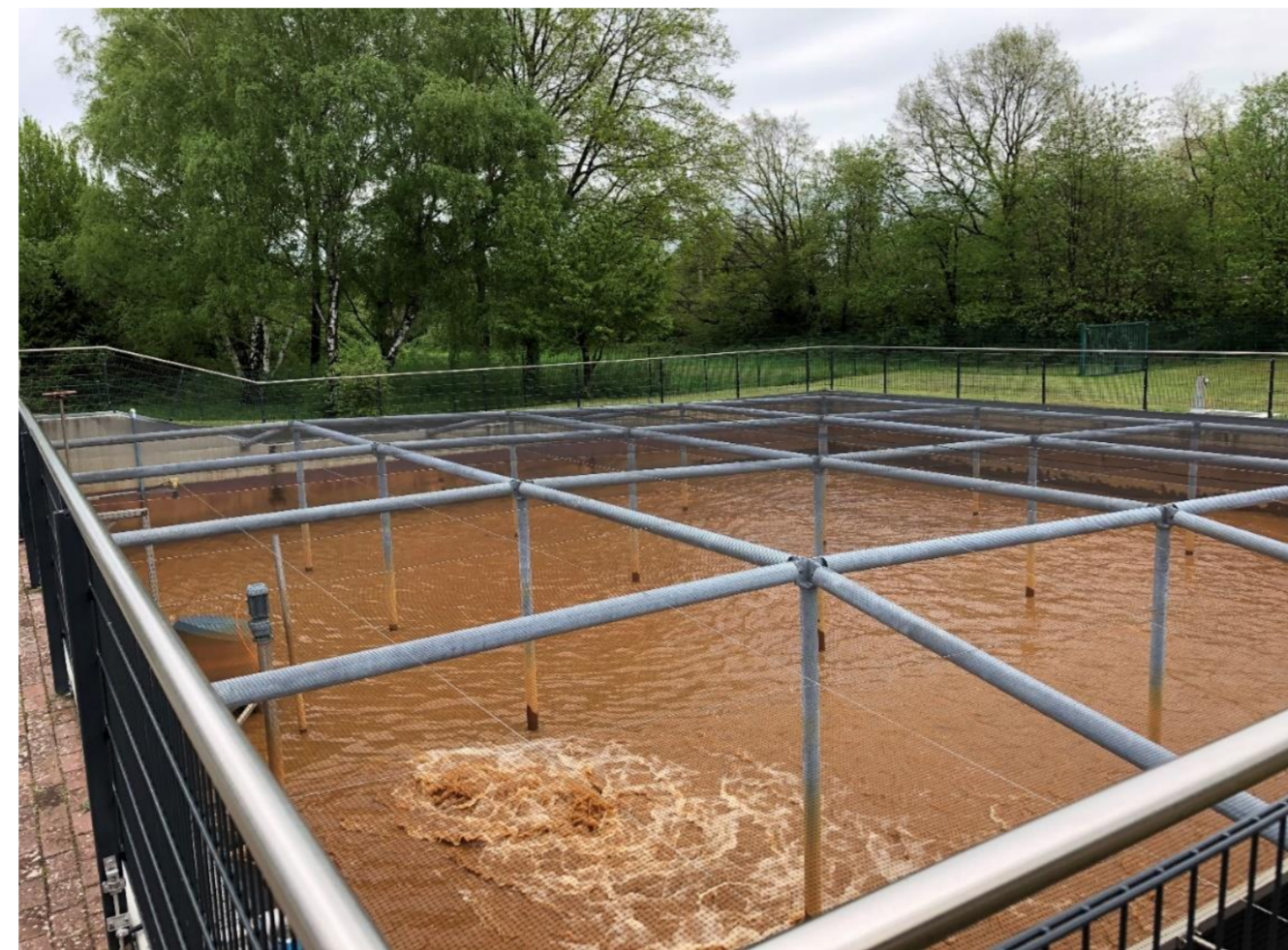
Vorlagebecken mit Mischer im Wasserwerk Süderelbmarsch (Quelle: HAMBURG WASSER)
