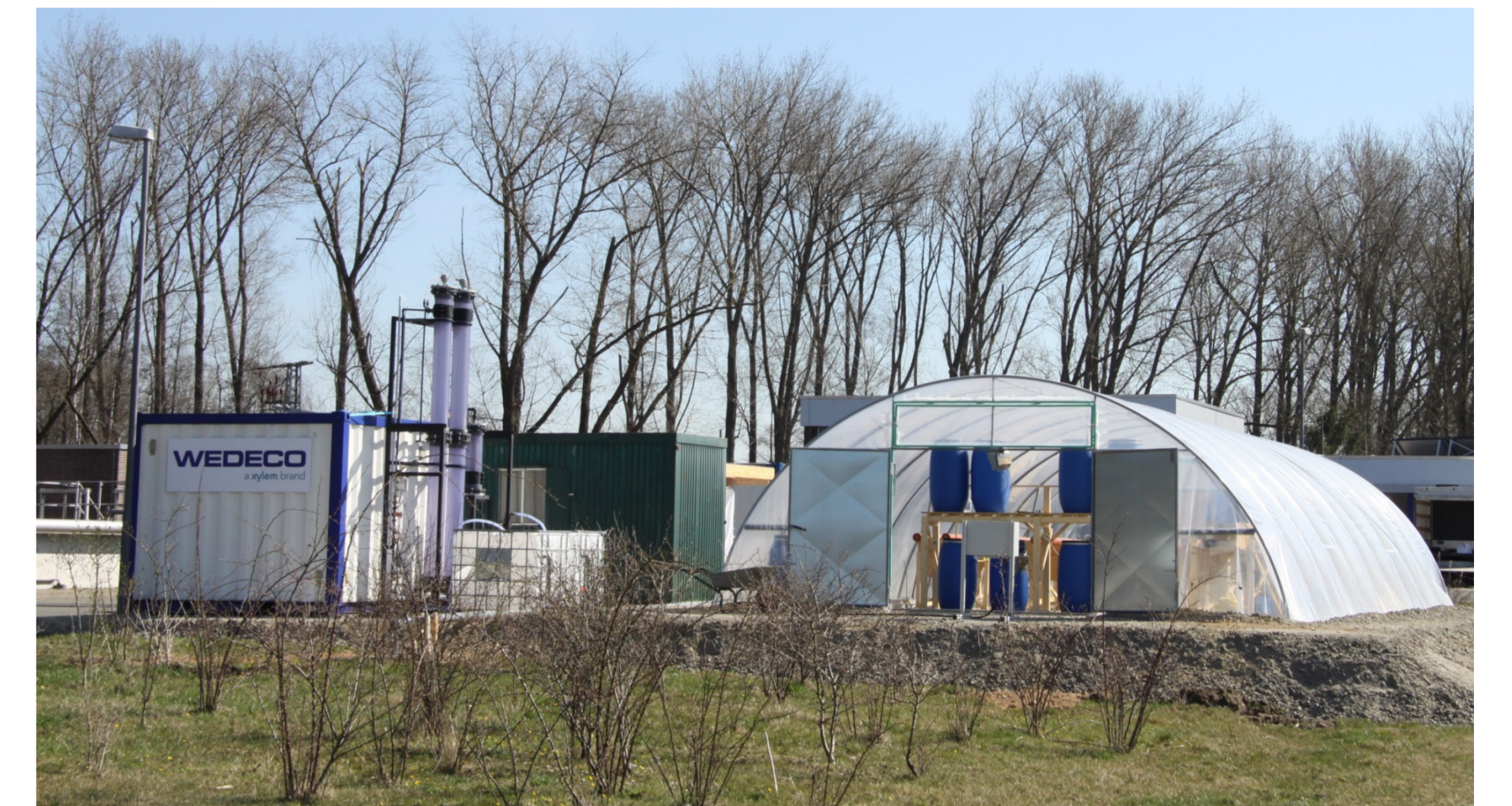
Abb. 1: Pilotierungsanlage Wolfsburg-Hattorf (Foto ISWW/TD)
