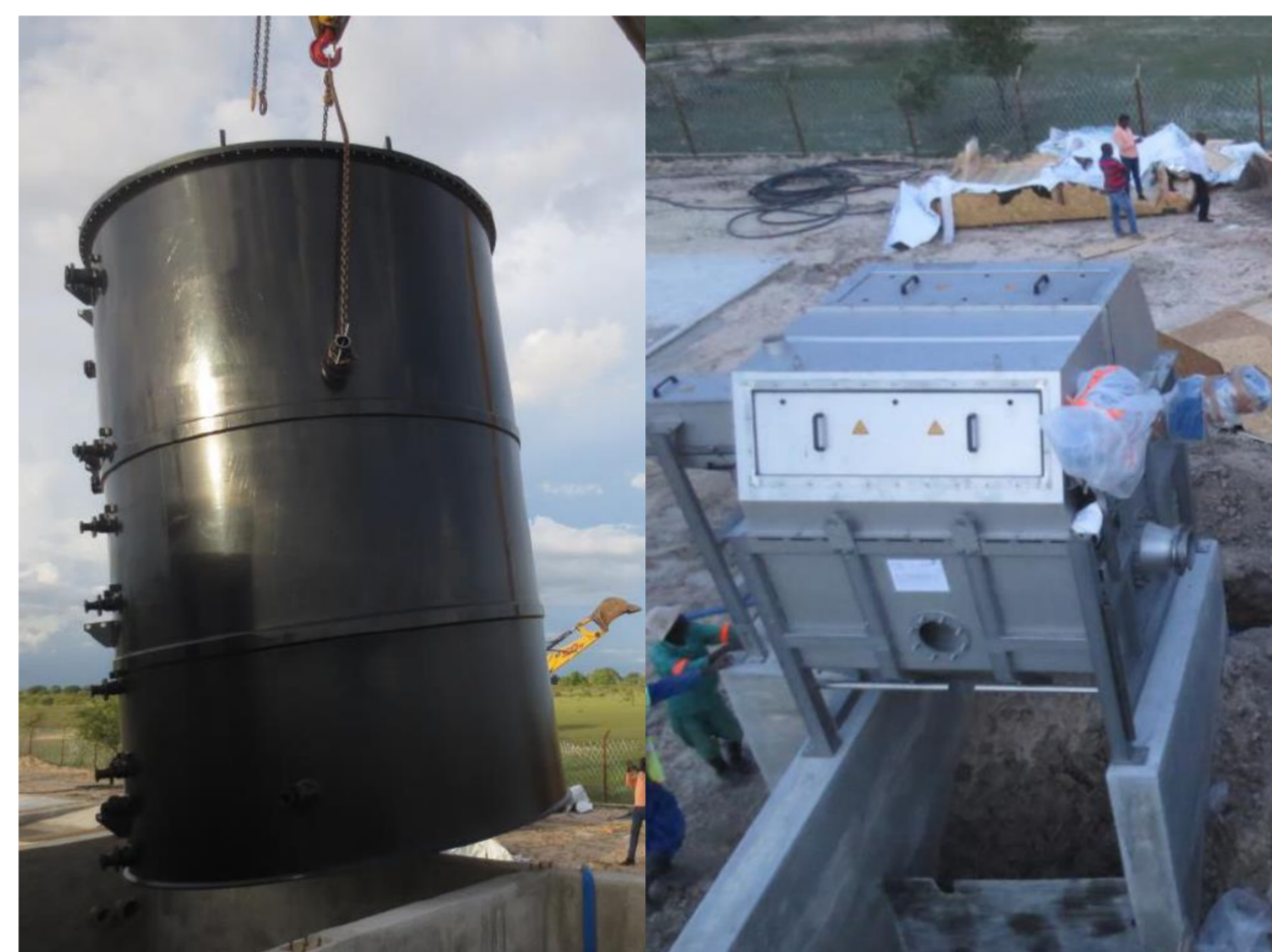
Abbildung 2: Installation UASB und Mikrosieb
