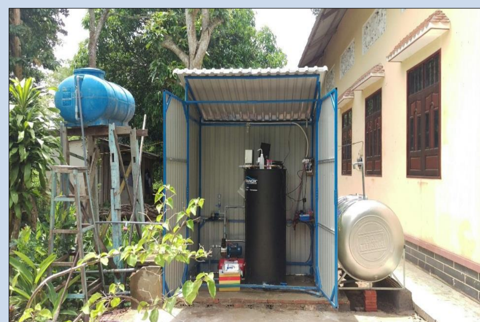
Abb. 2. Pilotanlage zur In-Situ Behandlung
