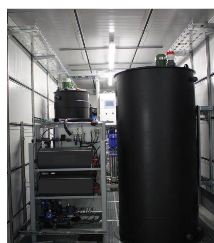
Aufstellung in Gesamtversuchsanlage
