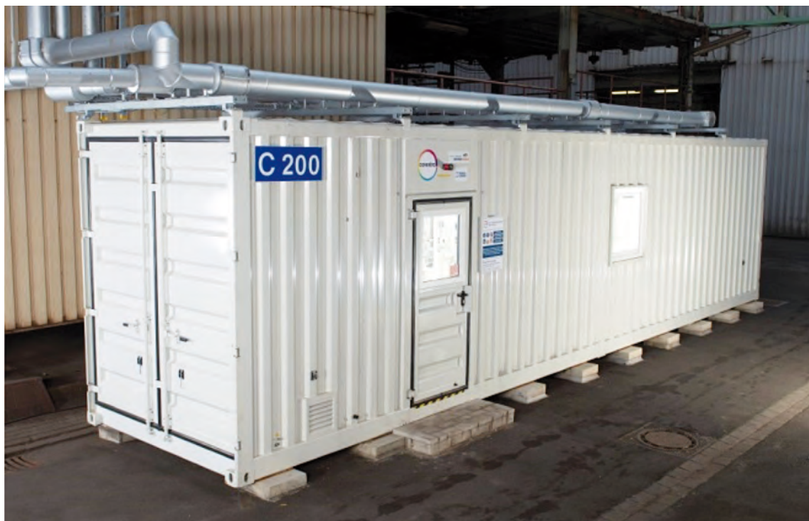
Abb. 25: Demonstrationsanlage am Covestro-Standort Krefeld-Uerdingen
