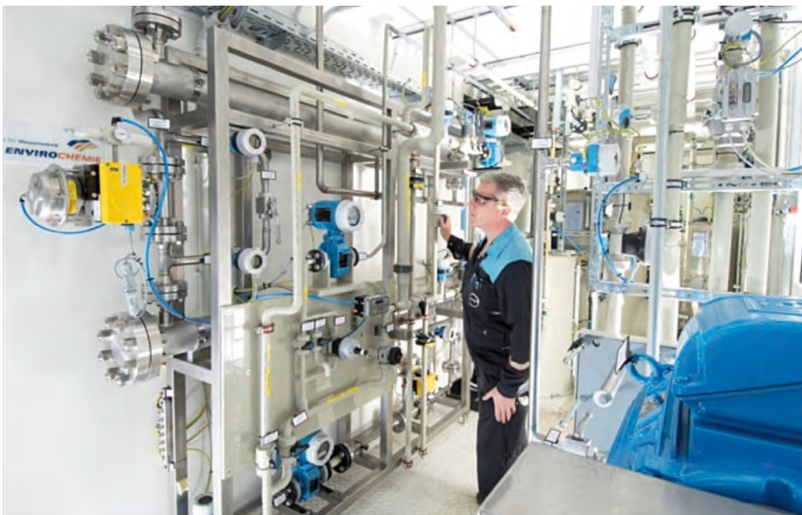
Abb. 26: Hochdruckumkehrosiose-Anlage für vier Spiralwickel-elemente
