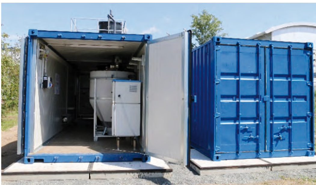
Abb. 22: Ansicht der gemeinsamen Pilotierung von der TU Darmstadt und EnviroChemie GmbH auf dem Werksgelände des assoziierten Partners Merck KGaA
