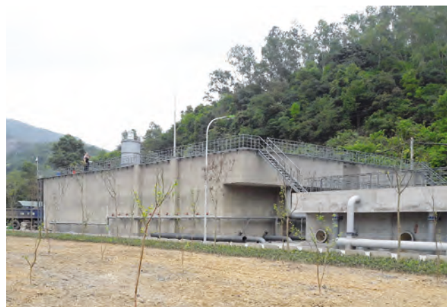
Abb. 16: Abwasserbehandlungsanlage Ha Tu (Drainage Unit Lo Phong)
