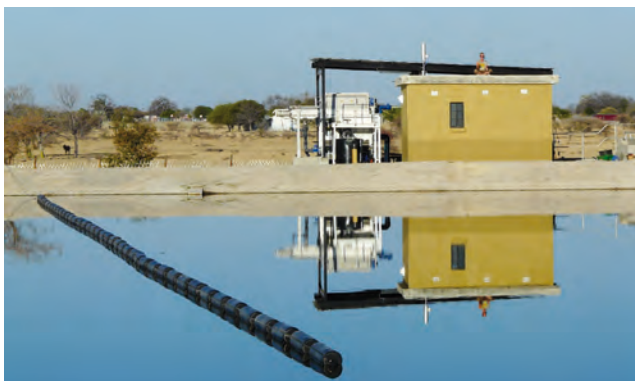
Abb. 8: Hauptteich: Erkennbar ist die Vorbehandlung im Hintergrund und eine der zwei eingesetzten Leitwände
