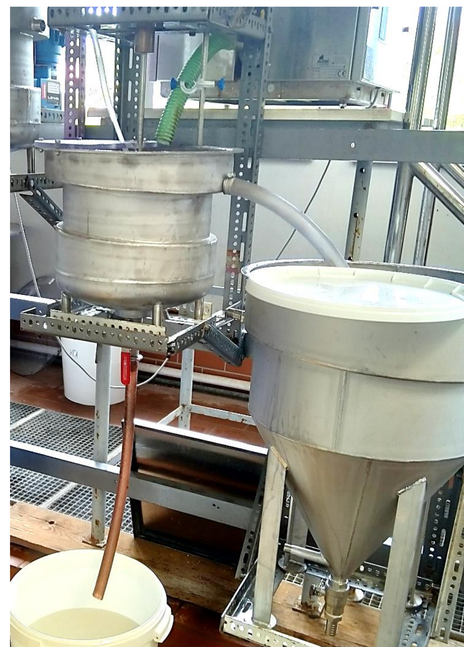
Anlagenteil Kristallisation für die Pilotanlage, Foto: K-UTEC 2024
