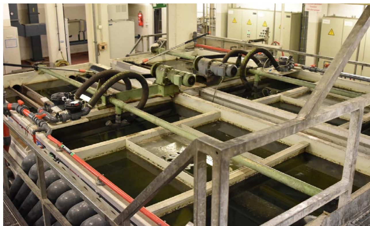
Anlage VW: Aktuelle Abwasserreinigungsanlage im VW-Werk in Braunschweig (Quelle: VW-Werk Braunschweig)
