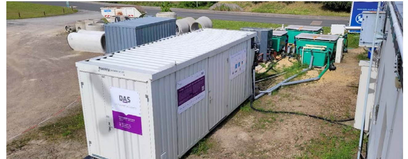
Pilotanlage zum Abbau von DMAc. Im Vordergrund: MBBR-Container, im Hintergrund: Vertikalfilteranlage (Quelle: Christian Koch, TU Dresden, Professur für Siedlungswasserwirtschaft)
