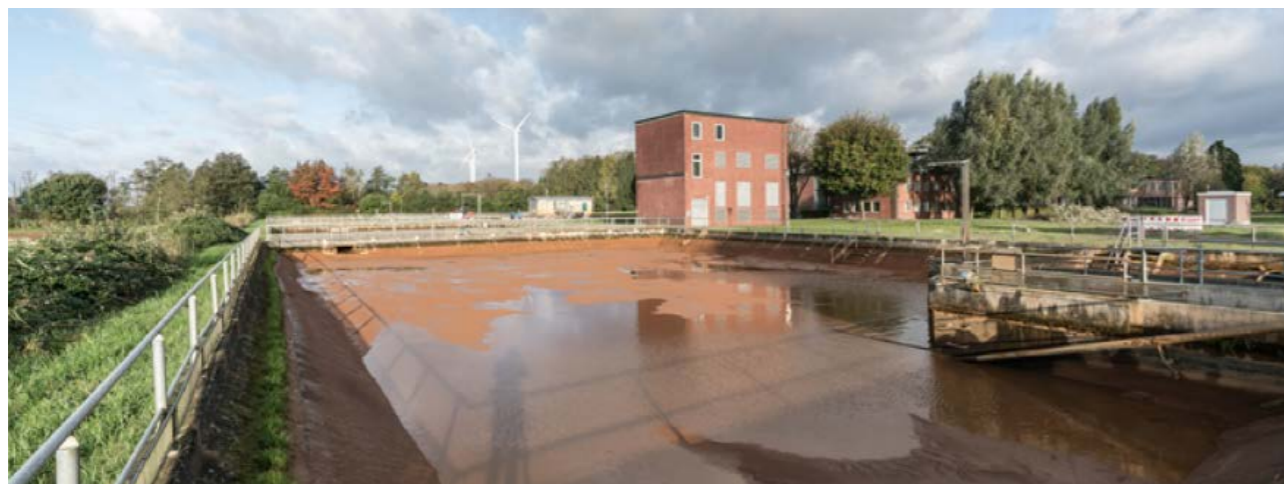
Absetzbecken für Filterspülwasser, Wasser nach Sedimentation abgezogen (Quelle: HAMBURG WASSER)
