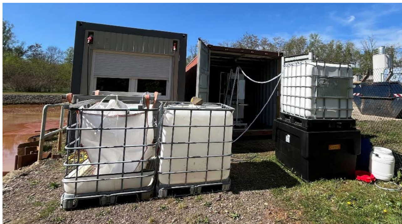
Installierte SULFAMOS-Pilotanlage am Feldstandort einer Wasserbehandlungsanlage. Rechts: Modul zur vorwärtsosmotischen Sulfatanreicherung, links Modul zur Sulfatabtrennung mittels Fällung als Gips (Quelle: G.E.O.S.)
