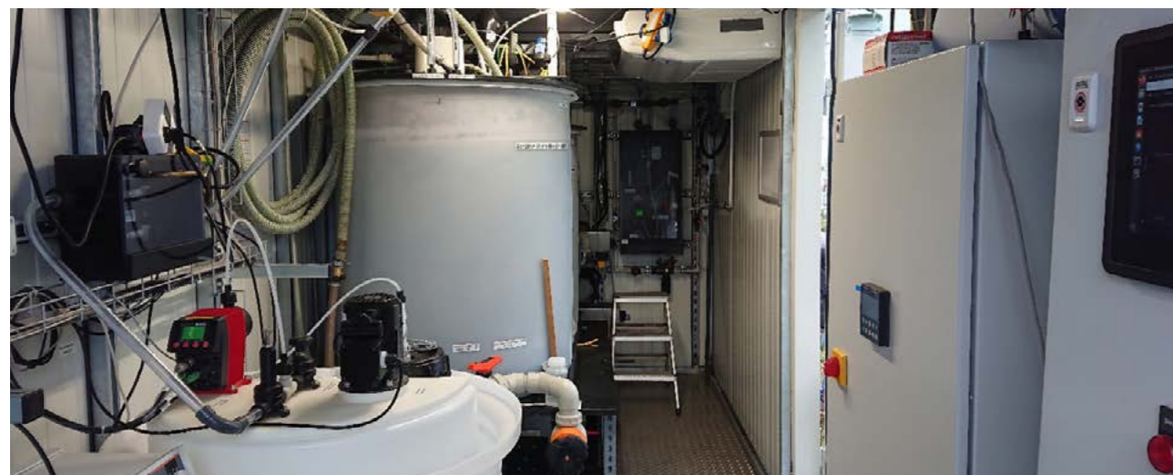
MBBR-Pilotanlage zum Abbau von DMAc (Quelle: Thomas Schalk, TU Dresden, Professur für Siedlungswasserwirtschaft)
