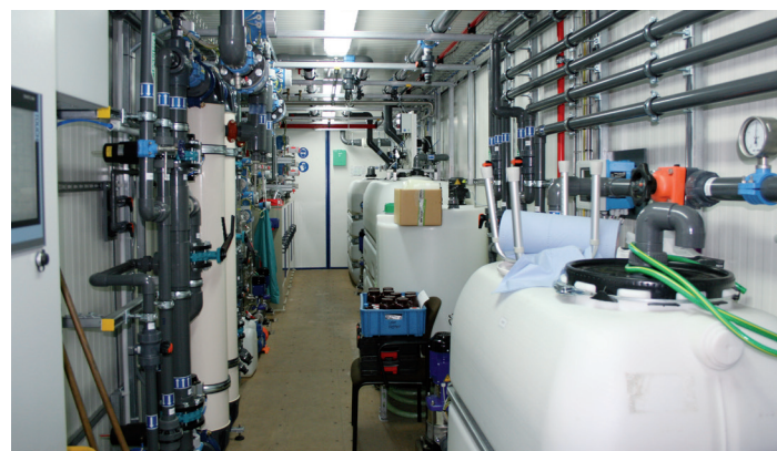
MULTI-ReUse-Pilotanlage in Nordenham (Foto: IWW)
