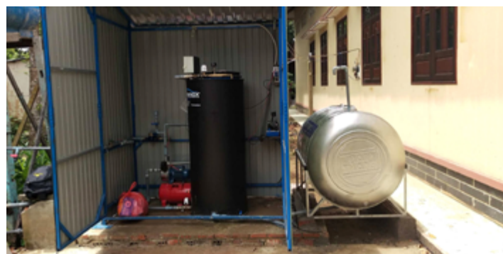
Fermanox®-Anlage zur Arsenentfernung in An Giang, Vietnam (Foto: Hien Ngu Lê)
