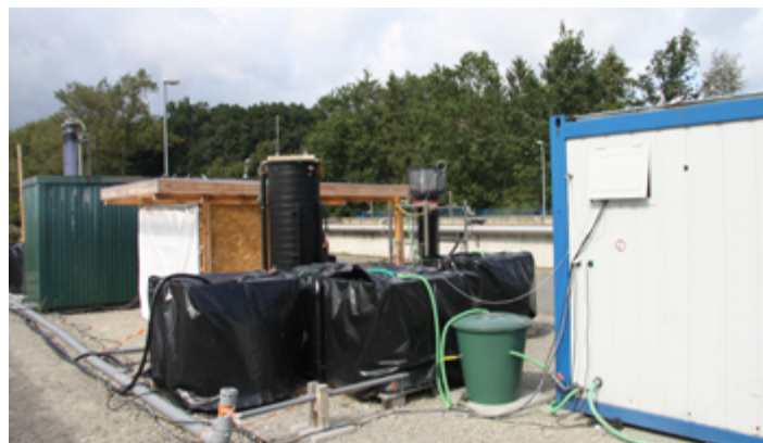
Anlagentechnik zur Aufbereitung des Abwassers für die Bewässerung (Foto: Dockhorn, ISWW, TU Braunschweig; September 2017)
