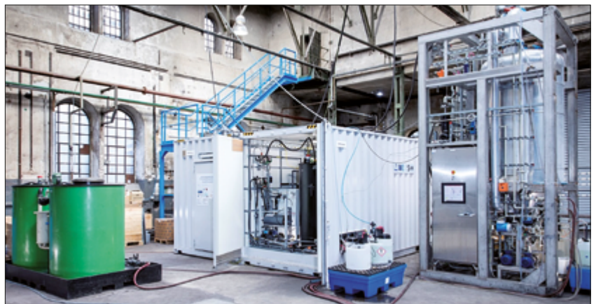
Abb. 10: Pilotanlage aus dem Projekt „WEISS“ zur Entsalzung von Kühlwasser (Foto: SMS group GmbH)
