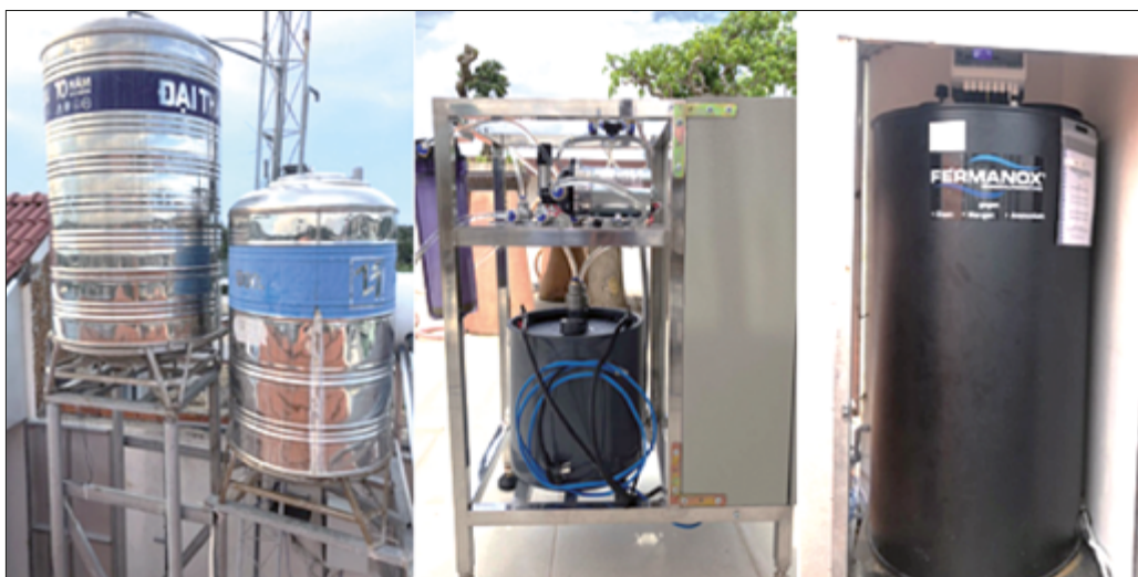
Abb. 3: Pilotanlage des Projektes WaKap in Tra Vinh (Fotos: Vu Luong)
